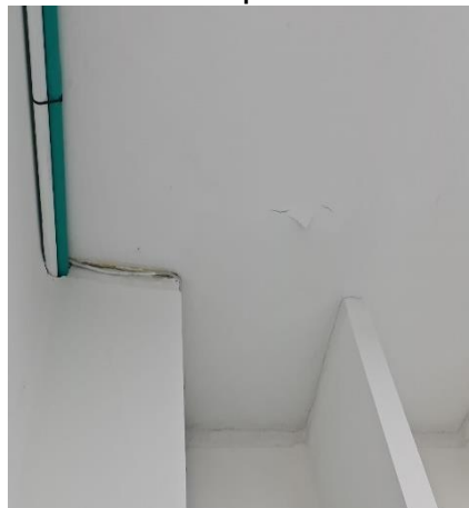
Humedad en techos
