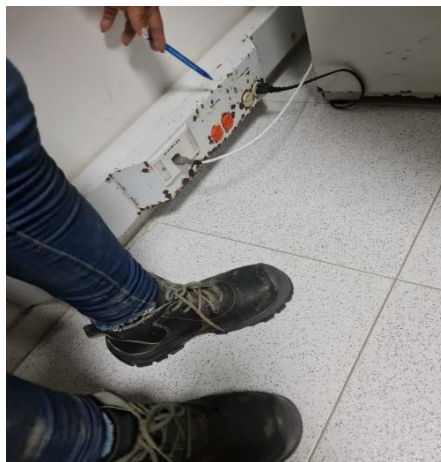
Falta de mantenimiento y pintura en los tomacorrientes
