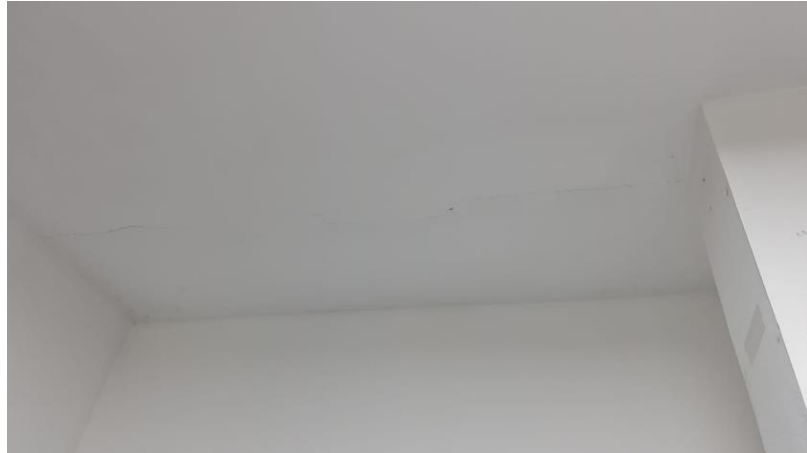
Oficina de control fiscal 1 piso al lado del baño, grieta en techo y pared, riesgo de desplome
