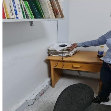
Muebles en mal estado, mantenimiento tomacorrientes
