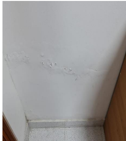
Humedad en las paredes
