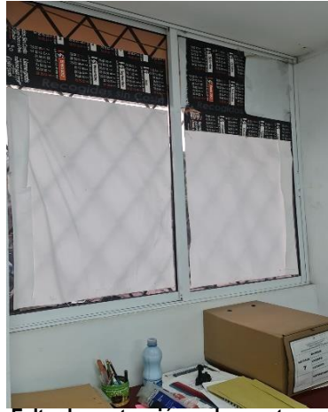
Falta de protección solar ventanas
