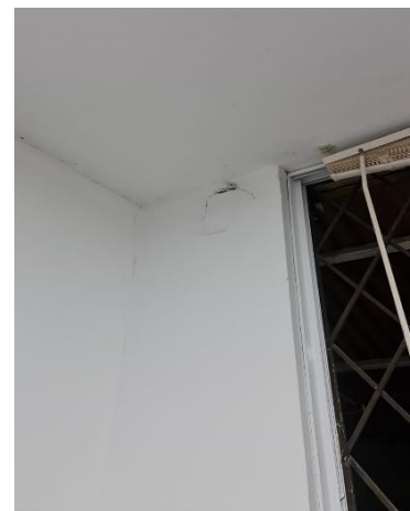
Humedad y cables expuestos
