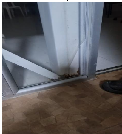
Humedad en la estructura de la ventana del auditorio del 1 piso, vidrios rotos
