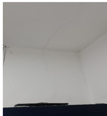
Humedad en techos 1 piso
