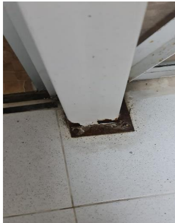
Humedad en la estructura de la puerta Del auditorio del 1 piso
