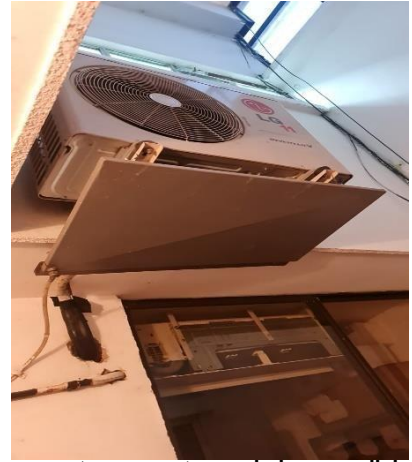
Falta de soporte y canasta en el aire acondicionado
