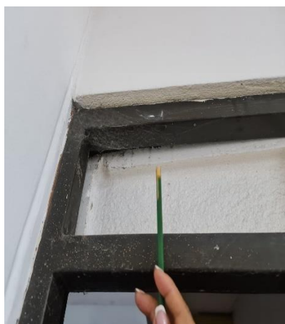
Falta de soporte estructura de las Puertas de los baños 2 piso
