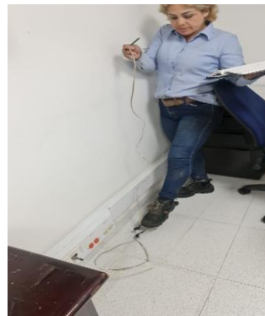
Falta de tomacorrientes y cables expuestos
