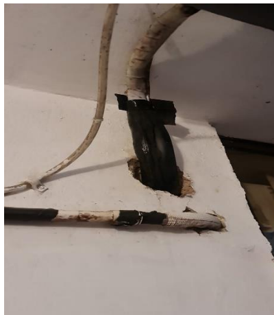
Fuga en el aire acondicionado
