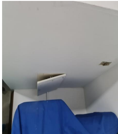
Cables expuestos, riesgo de desplome
