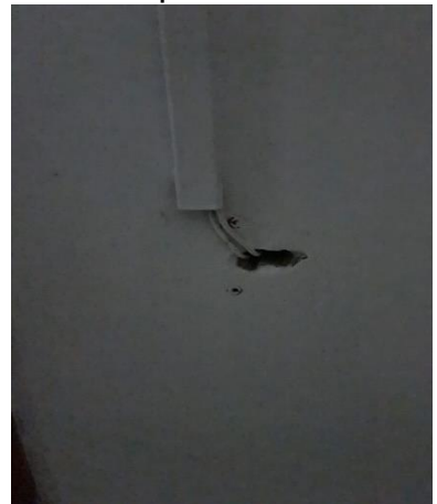
Falta de tomacorrientes y cables expuestos
