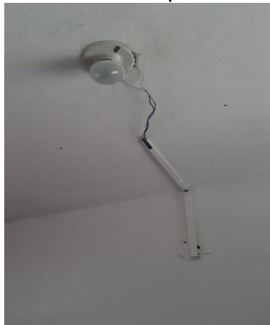
Falta de tomacorrientes y cables expuestos
