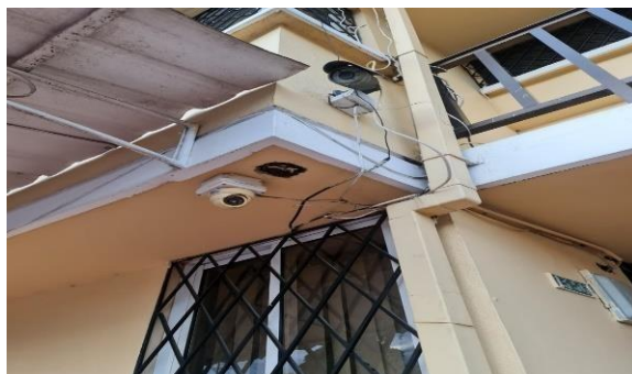
Humedad en las paredes
