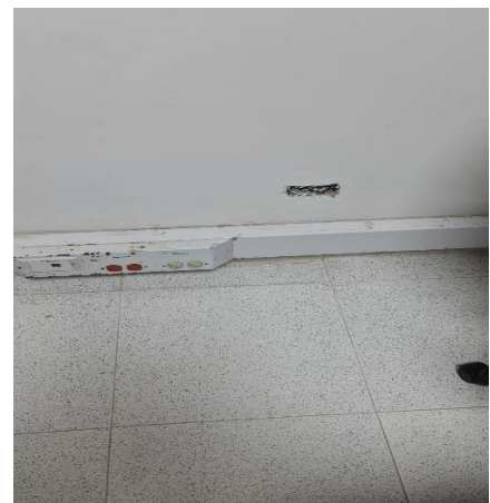
Cables expuestos, falta mantenimiento del auditorio del 1 piso
